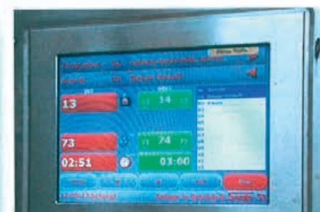
Eine Steuerung für zwei Anlagen
