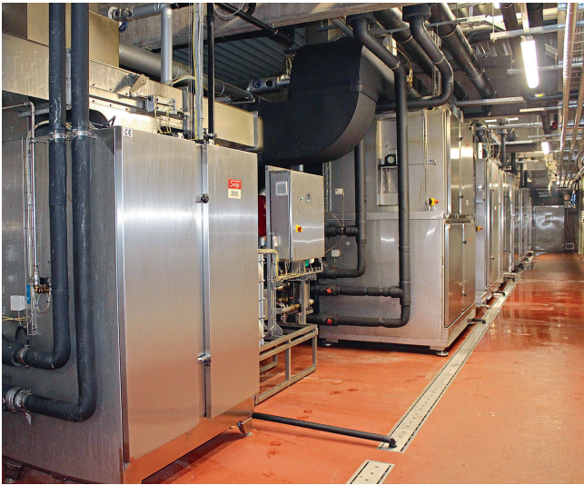
Der erzeugte Rauch wird über ein ausgeklügeltes Rohrleitungssystem in die richtige Räucherkammer geleitet.
