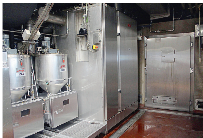
Der „g.g.A.-Rauch“ wird separat (Tür rechts) gemäß Produktspezifikation erzeugt.
