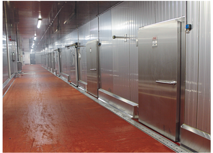
Insgesamt 260 Rauchwagen haben Platz in den 20- und 40-Wagen-Kammern der Anlage.
